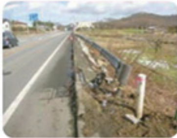
ガードレール・ 標識等の損傷
