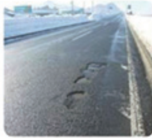
路面の穴ぼこ・ 段差
