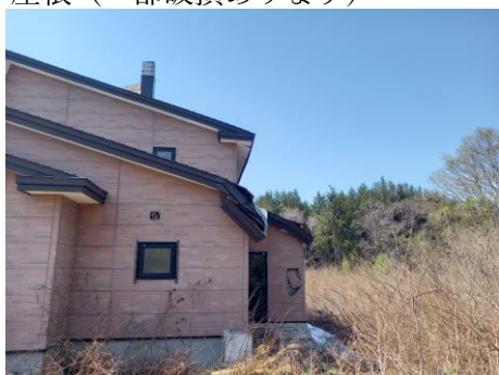
屋根（一部破損あります）
