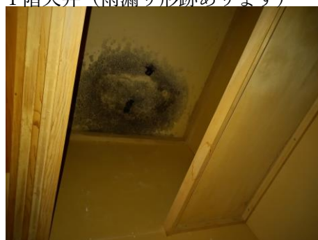
1階天井（雨漏り形跡あります）
